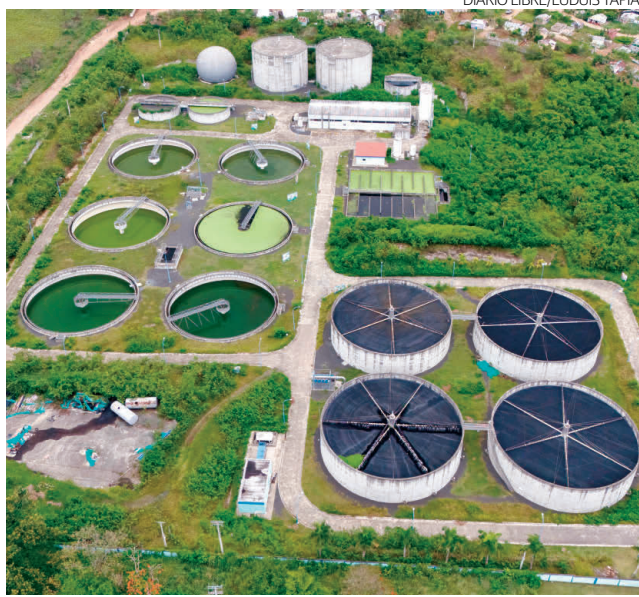
Planta depuradora de aguas residuales La Zurza.
