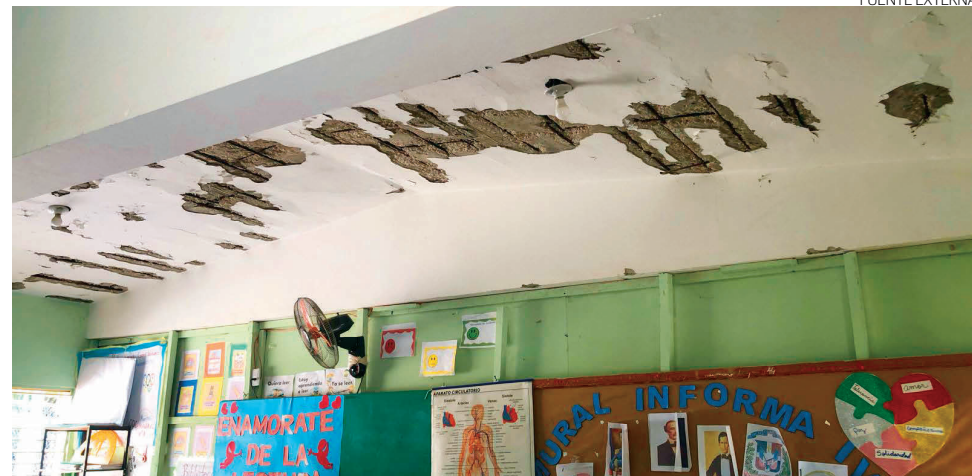
Techo con visible deterioro de una de las aulas de la escuela Amado Haro.
